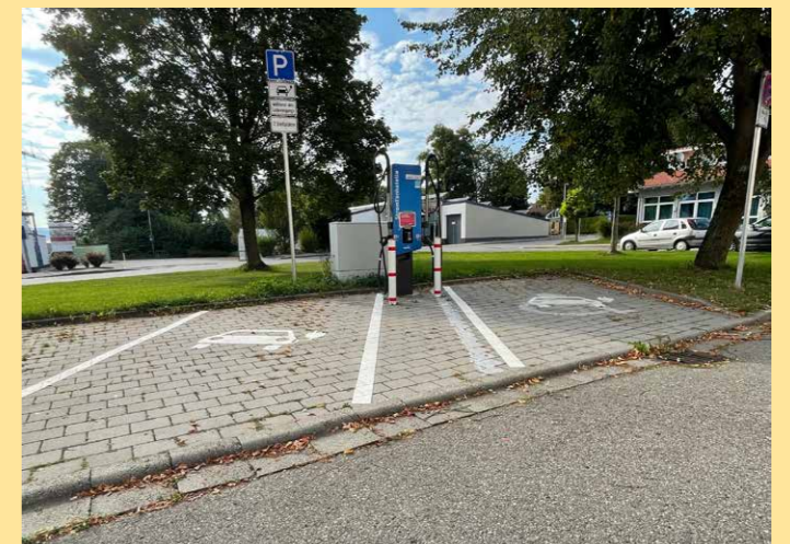
Ladeplatz (AÜW) im Ortskern von Lenzfried mit Bewegungsfläche zwischen den ladenden Fahrzeugen
